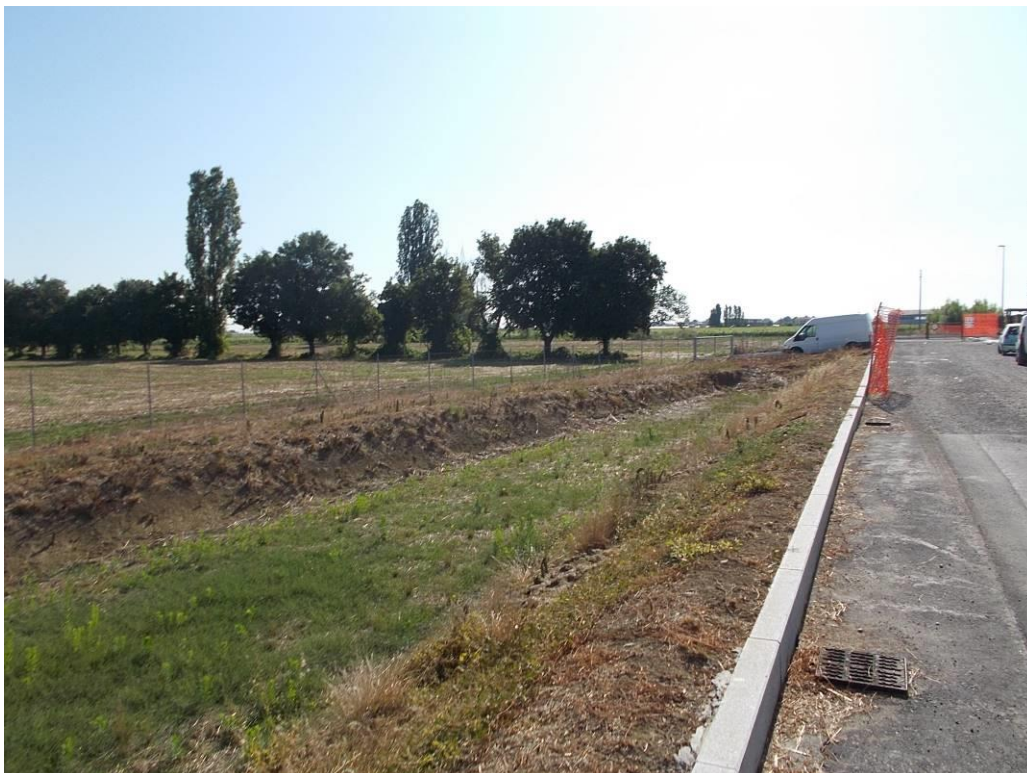
Foto 3 - Vasca di laminazione a servizio del Sub-ambito 2.2
